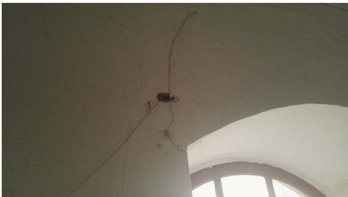
Obr. 13: Snímač pro měření pohybu v trhlině umístěný na severní obvodové zdi kostela
