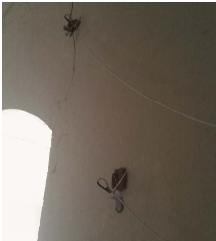
Obr. 14: Snímač pro měření pohybu v trhlině umístěný na jižní obvodové zdi kostela (nahore) a snímač na kompaktním zdivu pro teplotní kompenzaci (dole)
