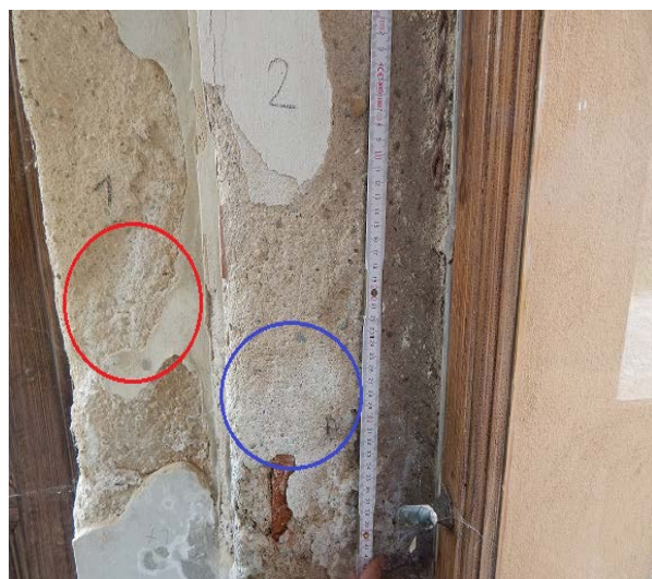
Obr. 10. Vyznačení odběrových míst (1A; 2A) v levém výklenku s významným zasolením ( \text{Cl}^- ; \text{SO}_4^{2-} )
