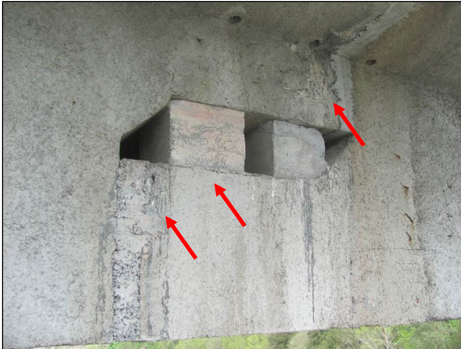
Obr. 3: Návodní strana, pole 3. Detail zmonolitněného kloubu uprostřed rozpětí. Na povrchích nebyly nalezeny známky zjevného poškození, jako jsou např. trhliny, drcení betonu, nadměrné deformace [1]
